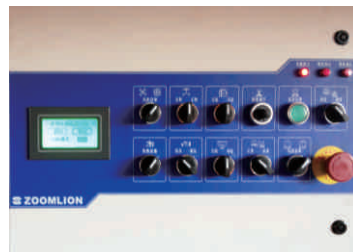
电机泵控制面板 Motor Pump Control Panel
