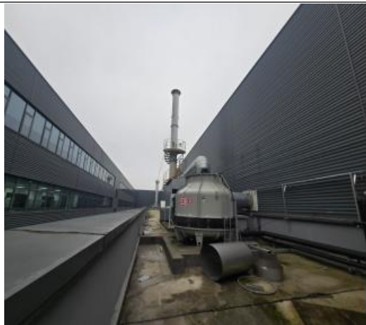
（DA042）喷塑固化、电泳烘干有机废气处理设施（天然气加热炉燃烧废气排气筒）
