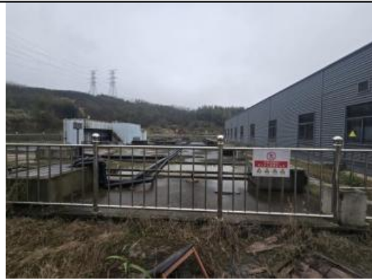
厂区污水处理站
